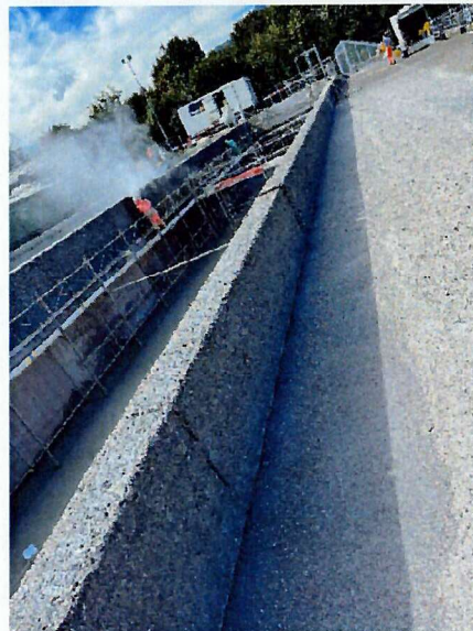
Betonabtrag an den Kronen
